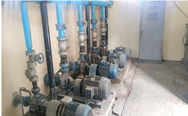
Gambar 3.5 Mesin Pompa Distribusi Ebara.
